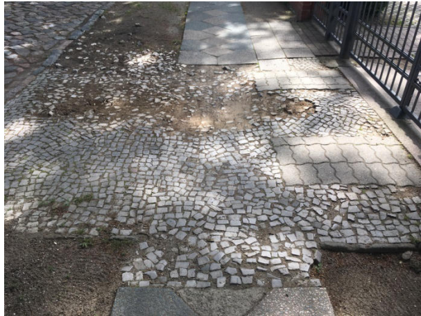
Nicht fachgerecht ausgebaute Grundstückszufahrt
